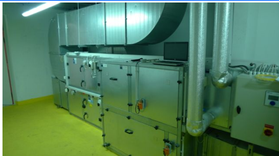
Viel Platz in der Lüftungszentrale, gute Zugänglichkeit
