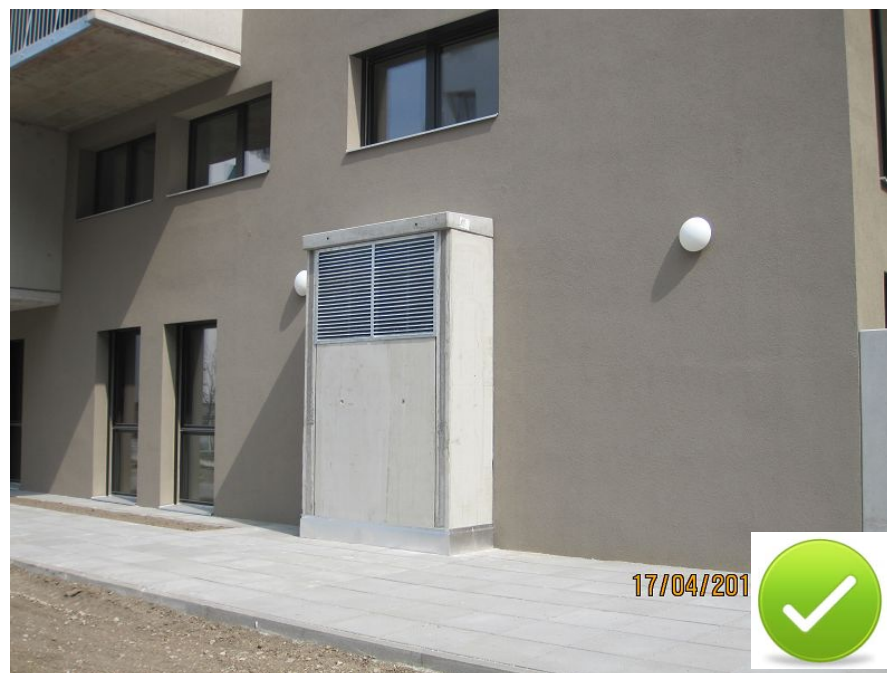
Außenluftansaugung ca. 2 m über Gelände
