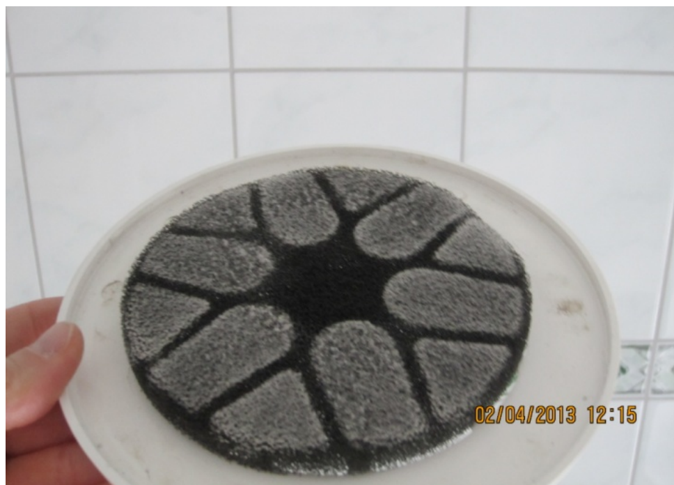
Filter bei Abluftdurchlass
