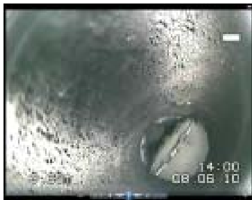
Zuluftleitung, von Gerät aus kommend
