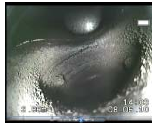
Abluftleitung, vor Abzweiger
